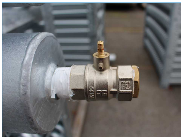
Horné spojenie výmenníka s uvoľňovacím ventilom tlaku na chladiacich vežiach s uzavretým okruhom s pripojením väčším ako ND100.
