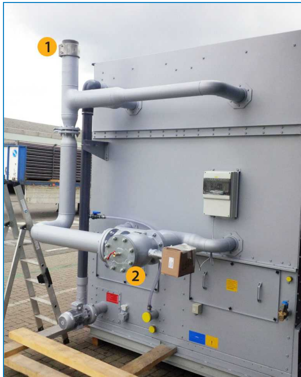
Блок с закрытыми наружными трубопроводами
