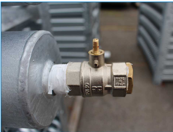
Niet-bedrade batterijaansluiting met drukaflaatklep op ijsaccumulatietoestel voor directe toevoer van koelmiddel.
