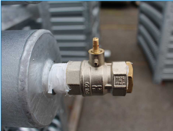
Oberer Rohrbündelanschluss mit Überdruckventil auf Verdunstungsverflüssigern.
