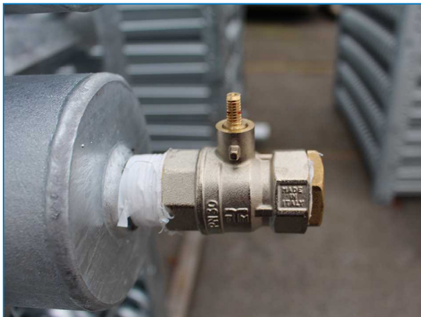
Oberer Rohrbündelanschluss mit Überdruckventil auf Verdunstungsverflüssigern.
